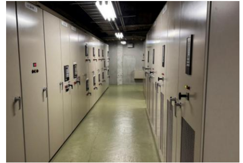
当館の基幹となる受変電設備
