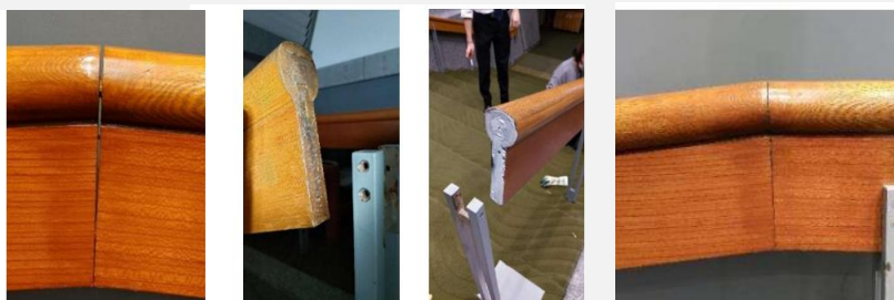
経年劣化により状態不良だった館内手摺を職員の手作業で修復
